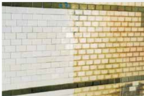
Reinigung von glasierten Fliesen
